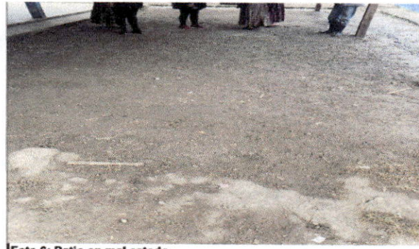
Foto 6: Patio en mal estado.
