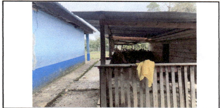
Foto 10: Barranda de cocina en mal estado.
