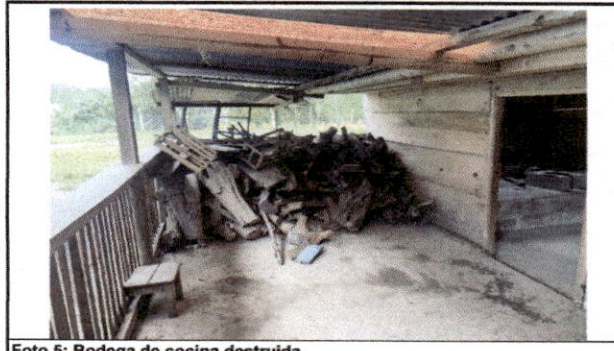
Foto 5: Bodega de cocina destruida.
