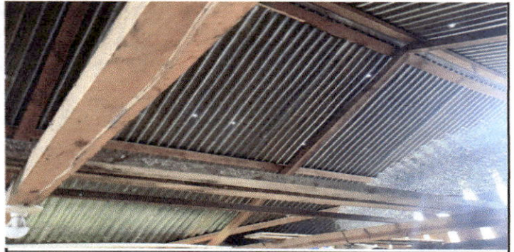
Foto 8: Estructura de madera y techo de lamina en mal estado.
